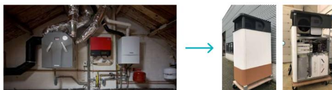
Exemple d'intégration tout-en-un dans un module énergie aux Pays-Bas
